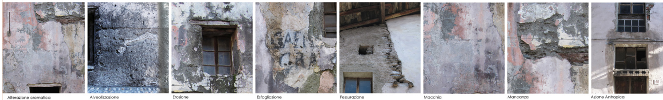
Alterazione cromatica Alveolizzazione Erosione Esfoliazione Fessurazione Macchia Mancanza Azione Antropica
